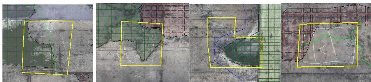
(a) パターンひび割れ+補修跡 (b) ジャンカ+補修跡 (c) 漏水・漏跡+補修跡 (d) ひび割れ+ジャンカ
