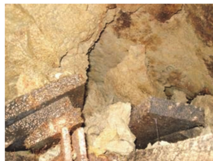
写真-2 覆工背面空洞内の状況写真
