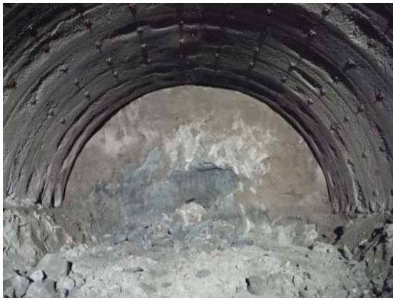
写真-5 上り線（D I S）岩盤破碎状況
