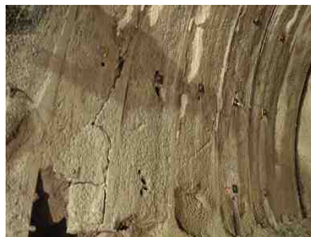
写真-2 トンネル側壁の押し出し変状
