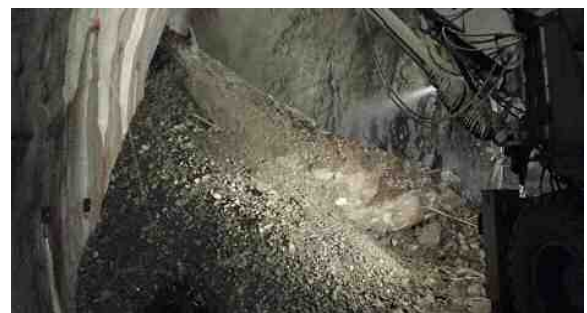
写真-1 トンネル側壁からの土砂流出状況
