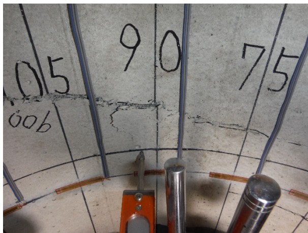
(a) 荷重1,000 kNにおける天端付近の様子
