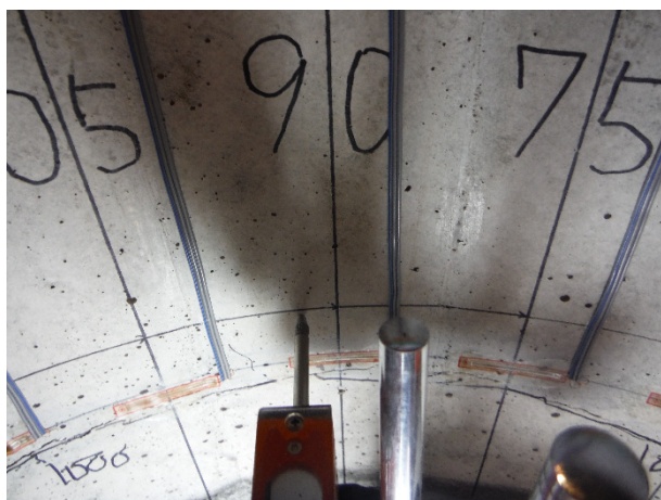
(a) 荷重1,200kNにおける天端付近の様子
