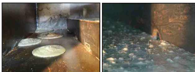
写真-1 空気抜き孔とスカーラップ（縦リブ）
