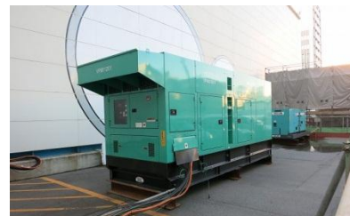
写真-4 ⑥予備発電機
