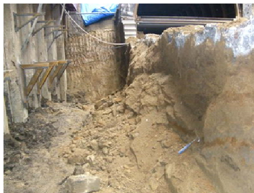
図-4.5 大分方未崩落箇所の地山状況
