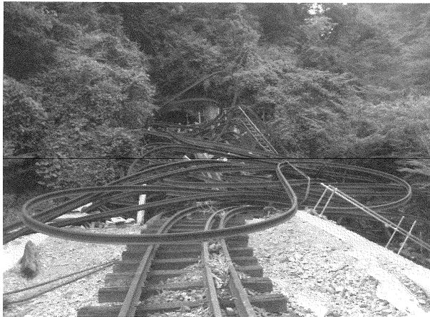
図-3.3 起点方明かり区間の線路流出状況 1)
