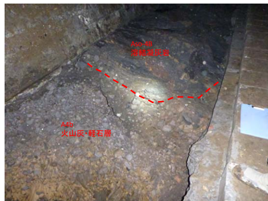
図-4.2 62k600m 付近の路盤浸食箇所観察された地層境界
