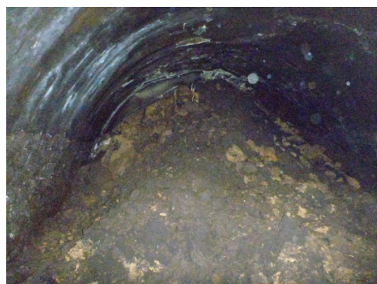
図-3.7 トンネル崩落箇所の坑内の状況（熊本方）
