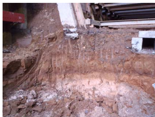
図-3.8 路盤部の状況（崩落区間開削時，大分側）
