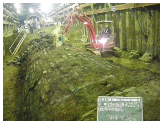
図-3.9 崩落区間アーチ部（大分側に向かって）
