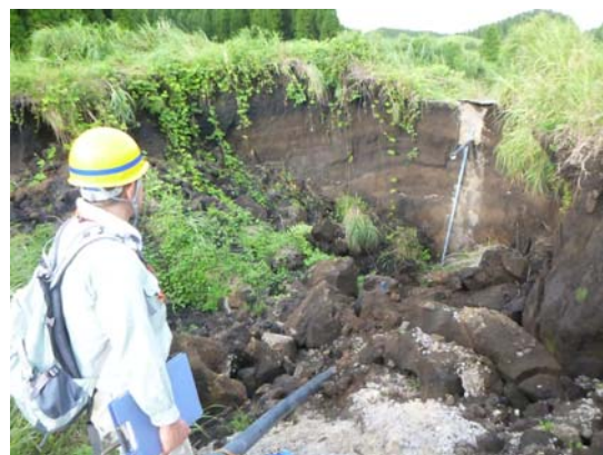
図-3.6 トンネル崩落箇所地表陥没の状況
