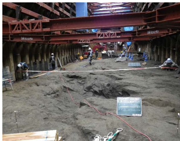
図-4.6 トンネル崩落区間における掘削底盤の状況(1)
