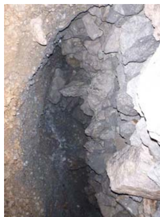
図-4.4 覆工背面の空洞
