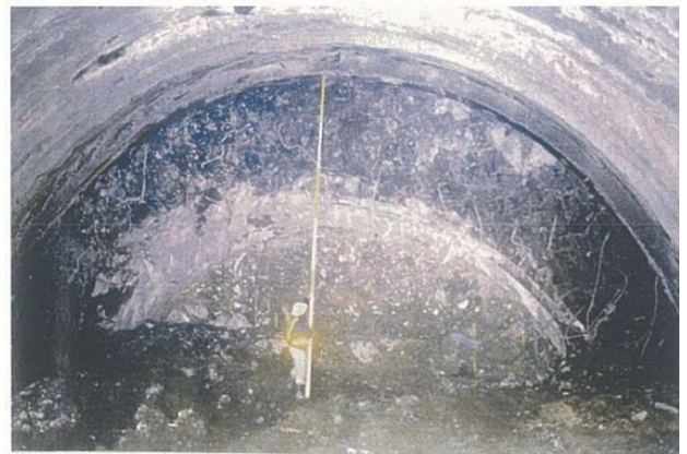
写真-1 I期線の支保工沈下状況 2)
