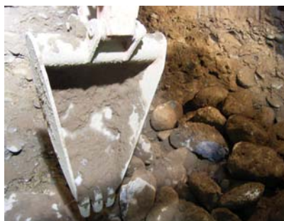
写真-7 礫混じり状況
