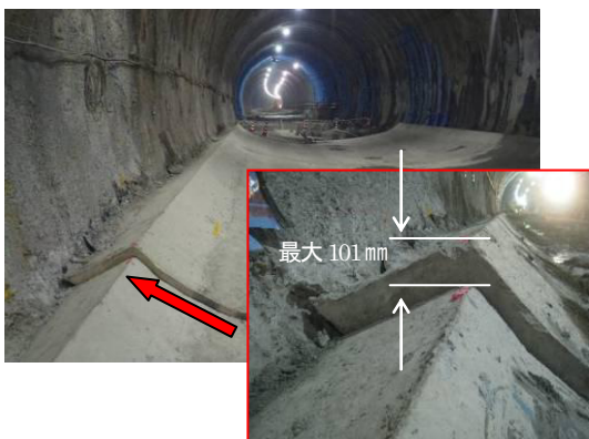
写真-1 インバートコンクリートの盤膨れによる隆起 (TD1, 715m)
