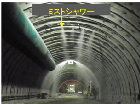
写真-4 ミストシャワー設置状況
