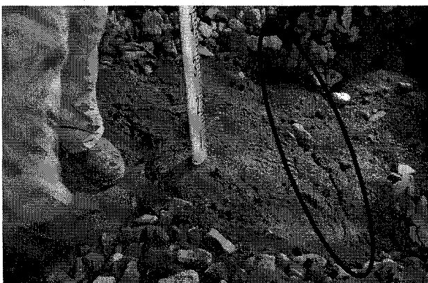
写真1 路盤内支障物対策試験ひび割れ発生状況
