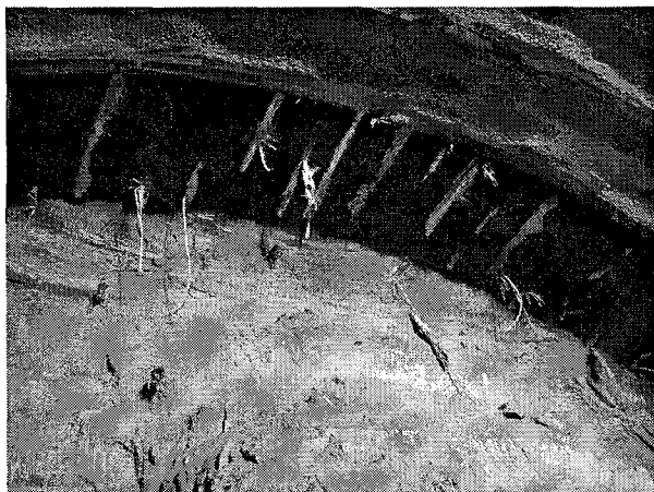
写真-5 GFRP チューブ下端部までの抜け落ち
