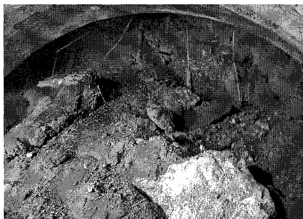
写真-11 切羽崩壊状況（下り線 STA. 64+58）
