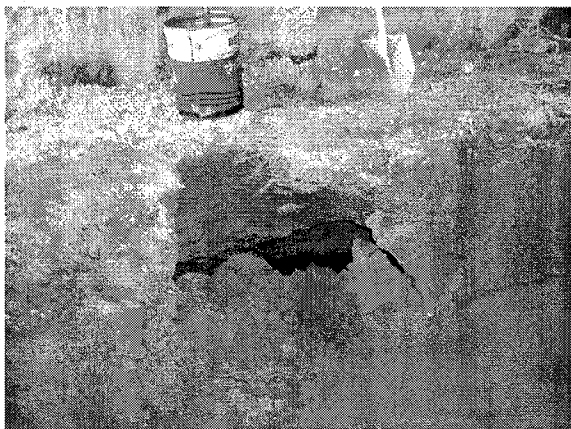
写真-8 改良体近傍の空隙状況
