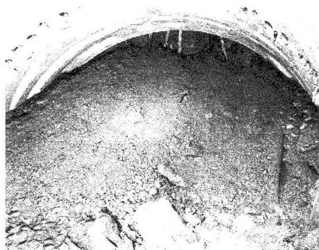
写真-1 第二回崩落状況
