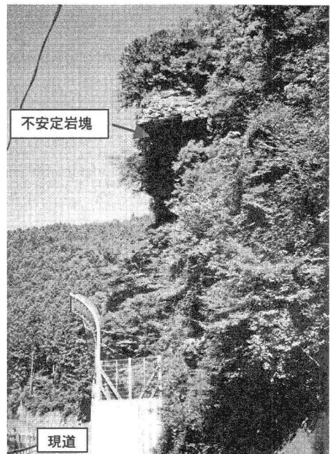
写真-1 不安定岩塊の状況
