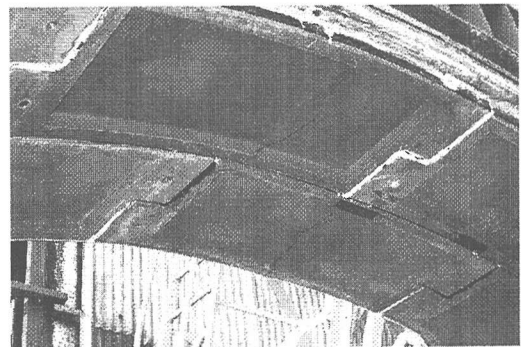
図-6 破壊状況 (クラウン部)
