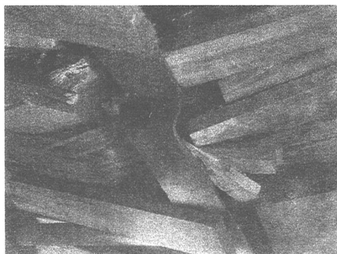
写真-1 鋼製支保工・座屈状況
