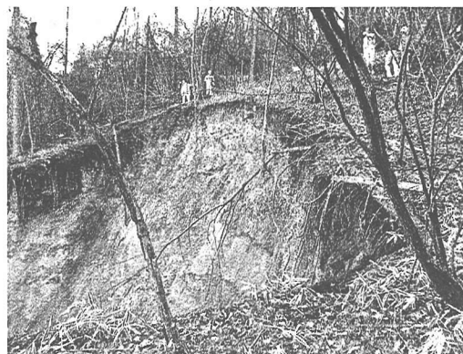
写真－２ 地表面の陥没箇所
