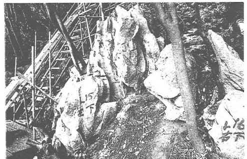
写真-2 坑口上部斜面浮石状況
