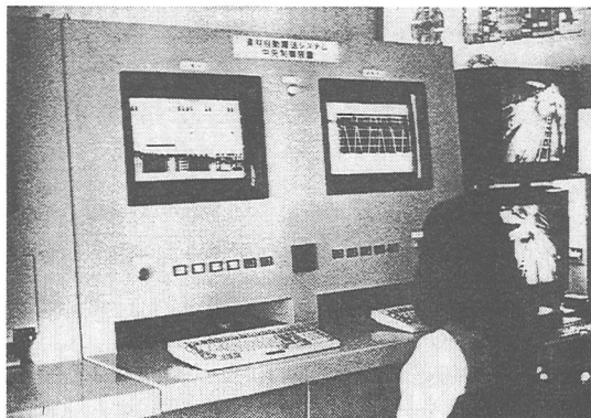
写真－１ 中央制御装置
