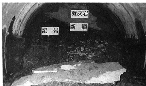
写真-3 切羽の崩落状況
