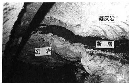
写真-2 断層を挟む強度の低い凝灰岩と泥岩
