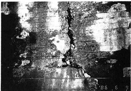
写真－2 長期にわたる漏水による覆工劣化の例
