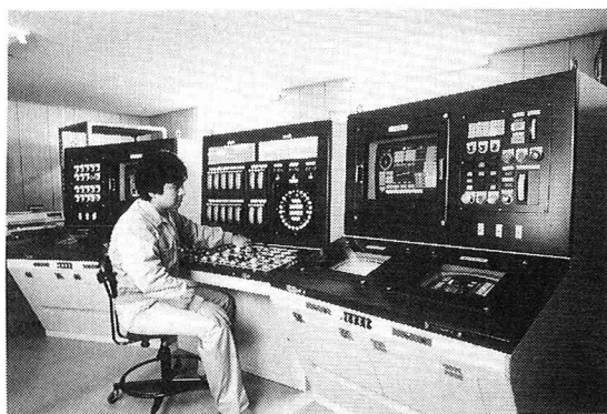
写真-1 中央施工管理盤
