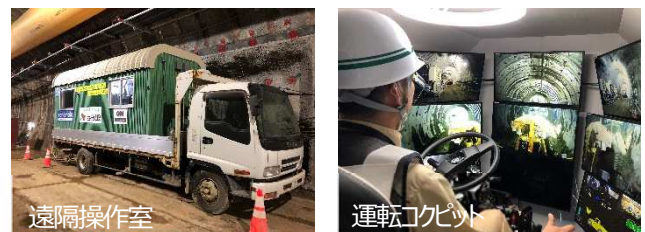
図-3 遠隔操作室・運転コックピット
