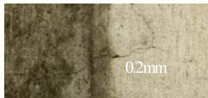
損傷写真例 (UAV 点検結果)
