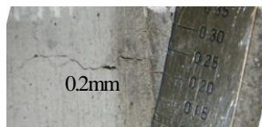
損傷写真例 (目視点検結果)
