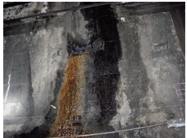
図-1 漏水したコンクリート
