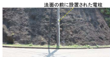
図-1 凹凸の激しい法面と設置された電柱
