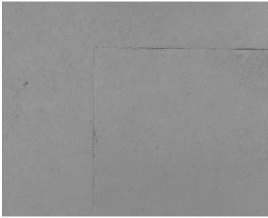
図-6 元の点検写真
