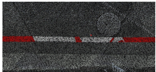
図-4 白線の劣化部 RiSCAN PRO 選択した例 (赤部分)
