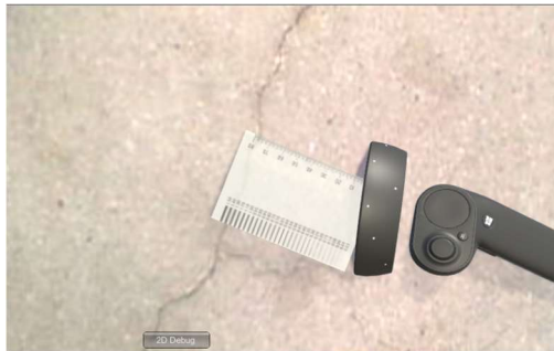
図-5 クラックゲージによるひび割れ幅の測定
