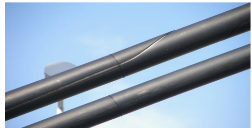
図-1 斜材保護管の損傷(保護管の割れ)例
