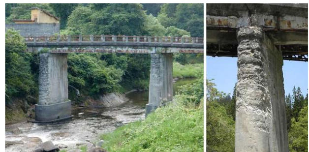
図-1 スケーリングした道路橋の例
