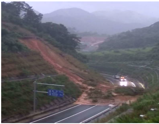
写真-1 斜面崩壊による被災直後例
