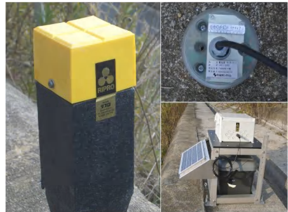
図-2 現場計測設備
