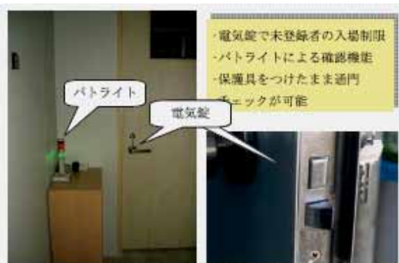
写真-2 入場扉と電気錠
