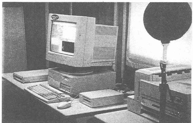
写真1 システム管理室内
