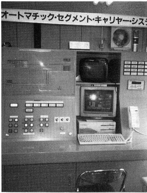
写-5 中央監視装置
