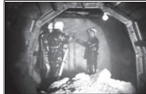
写真11 鋼製支保工 (F16 30:08)
