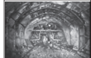
写真8 鋼製支保工 (F09 3:50)
