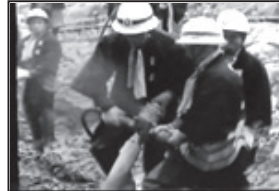
写真43 エアパイプレータ (F03 35:28)
