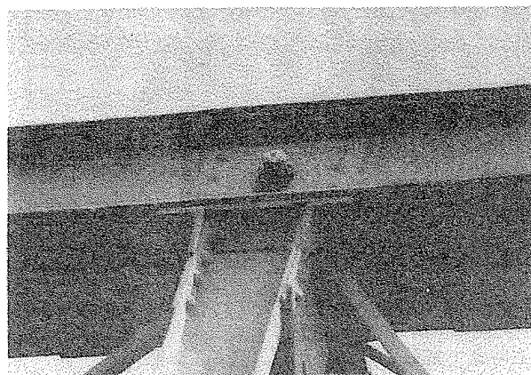
写真-7 上弦材と中間垂直材の取付けおよびピンのナット脱落
