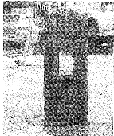
写真2 石引通木樋継手木(撮影:青木、1982)
