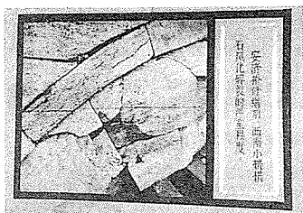
写真-8 だぼ穴からの亀裂
