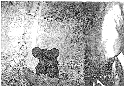
写真4-10 アーチ石横一列が浮き上がった様子（中国、永濟橋）
