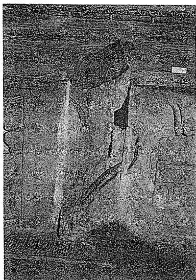
写真4-14 高欄支柱の崩壊状況（中国、盧溝橋）
