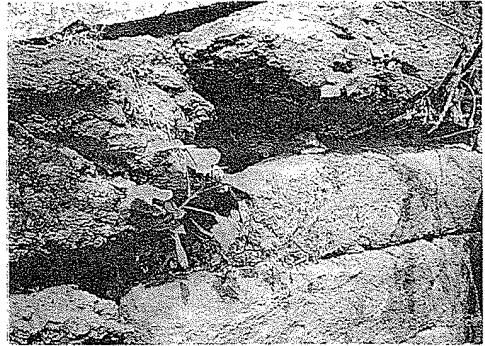
写真4-2 壁石が崩壊し中詰めの様子が見える(中国、普濟橋)
