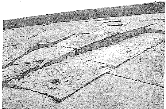
写真4-12 壁石の孕み出し現象（鹿児島、高麗橋）
