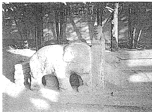
写真4-15 親柱を支える象の損傷状況（中国、盧溝橋）
