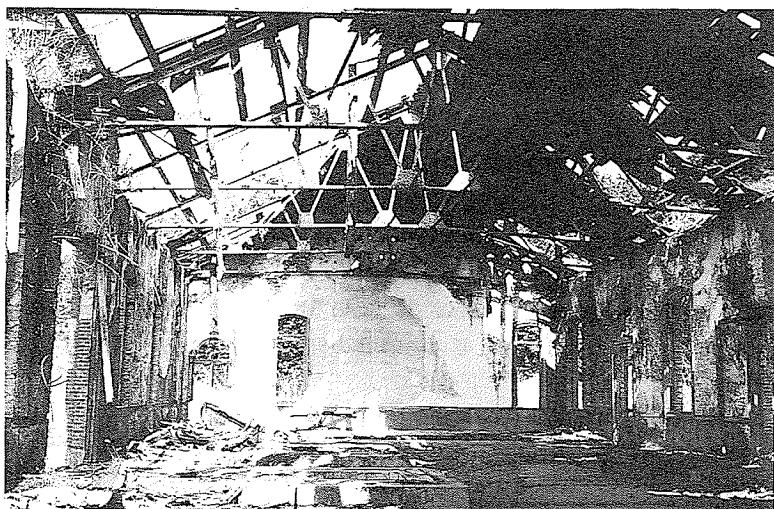
写真13 丸山変電所機械室の荒廃状況 1996年
