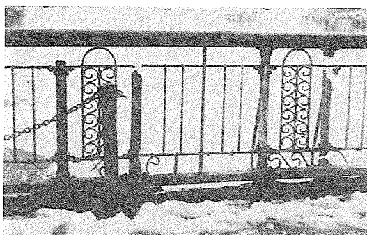
写真-14 昭和32年補修前の大橋の高欄
