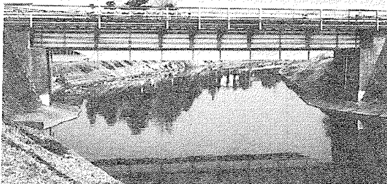
写真14 作30年式60ftをT型溶接補強した例、成田線第1手賀沼悪水橋梁[1992. 2. 16西野]
