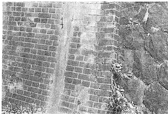
写真-10 碓氷第八号トンネル(No. 8)入口方の坑口側壁部のれんが '92.3.29
