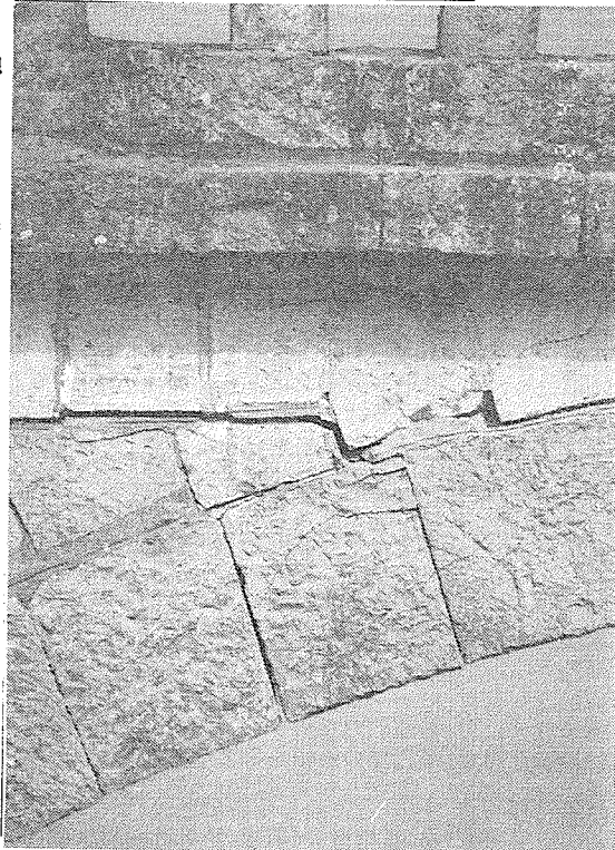
写真-2 玉江橋の輪石の隙間(撮影：二宮, 1992. 4. 3)
